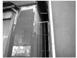
写真16 外壁のモルタルがはがれ、建築当時のレンガが現れた様子
